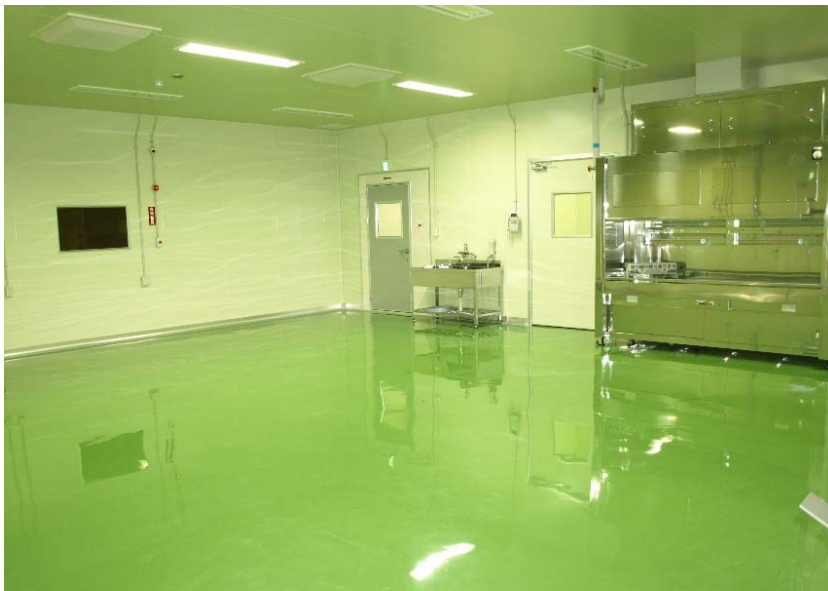
クリーンルーム クラス10000 エアシャワー完備
